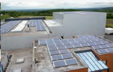
Herion : Installation de 76 kWc, soit 304 panneaux
