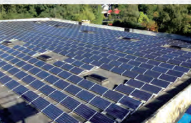
Walibi : Installation de 250 kWc, soit 1000 panneaux
